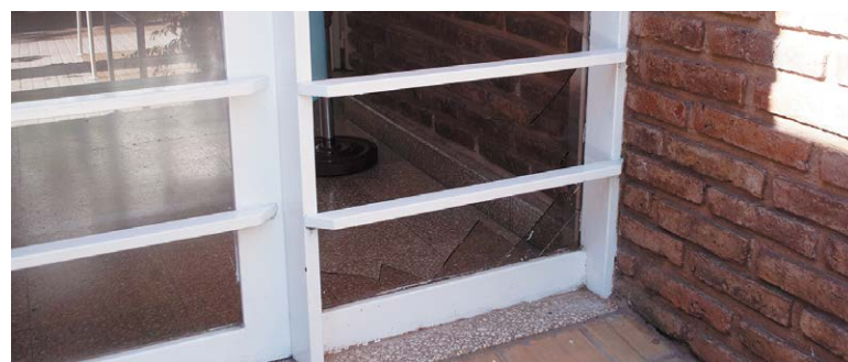
Ingresaron rompiendo el vidrio de la puerta del frente.
